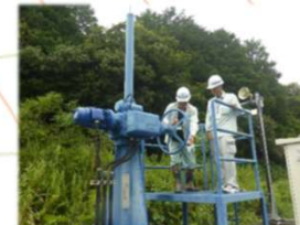
現地でのバルブ操作
